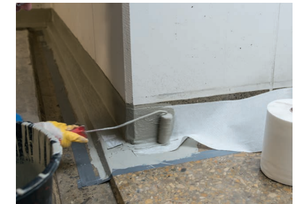
Abdichtungsebene Vliesarmiertes Abdichten von Details: Harz vorlegen – Vlies einarbeiten – mit Harz sättigen
